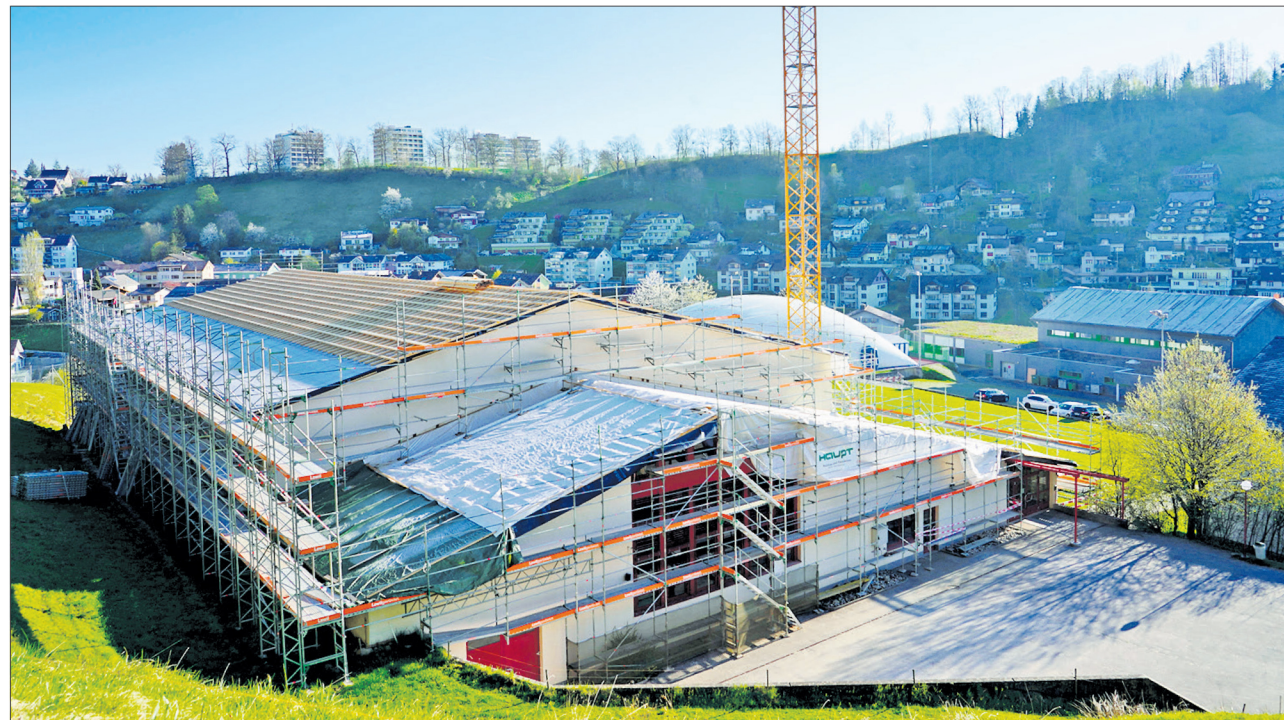
Das Dach der Sporthalle Berghof soll mit einer Photovoltaikanlage, umgesetzt von der EGRW, versehen werden. [Bild zvg]
